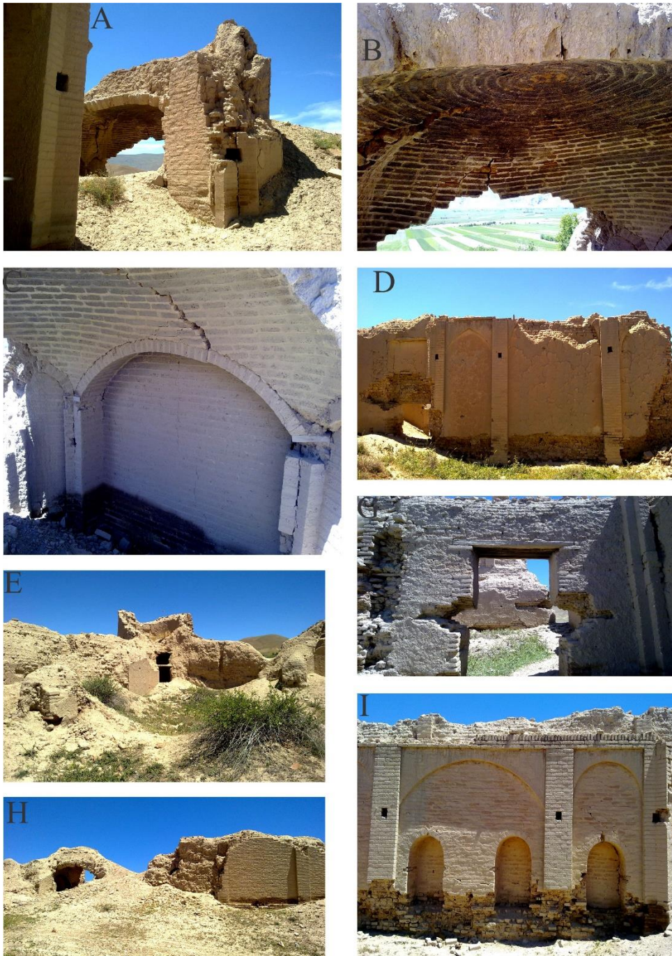
شکل ۵. عکس‌هایی از قلعهٔ کرج شامل A-C, H: نمای داخلی و بیرونی گنبد بر روی هشتی که پس از ورودی قلعه قرار دارد، D-F, I: نمای داخلی قلعه با دید به سمت شمال شامل دیوارها و درب‌های داخلی و برج ضلع شمال غربی به همراه آسیب‌های وارده به آن (نگارندگان)
